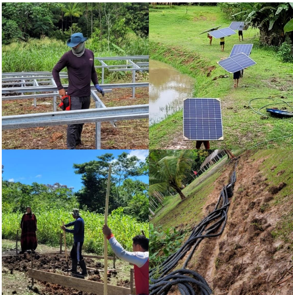
Figura 2. Esforços de transporte e instalação dos sistemas de energia solar.
